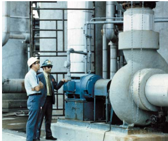
Uma 3175 instalada em uma grande indústria química.
