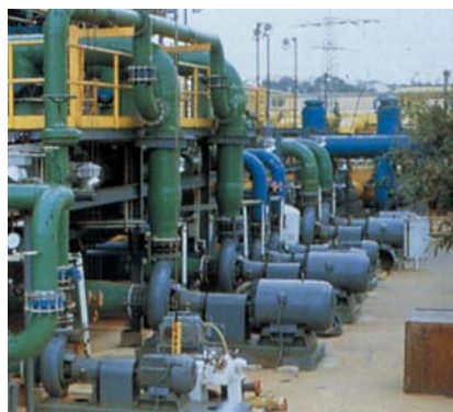
Bombas Modelo 3175 em serviço de processo como evaporadores multiefeito.
