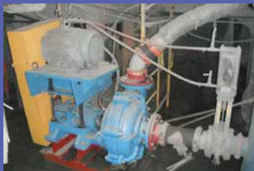
Первичный насос питания циклонов на сырьевых металлургических комплексах
