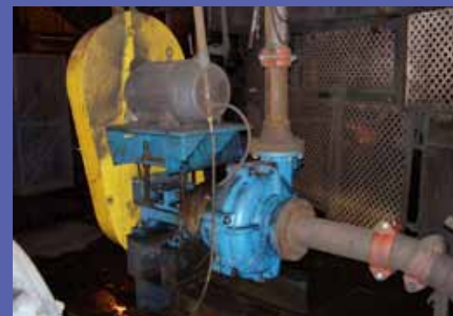
Насос нижнего продукта илоуплотнителей на углеобогажительных комплексах
