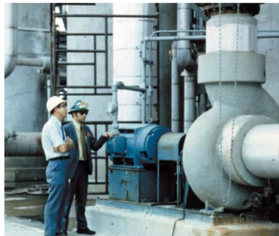
Uma 3175 instalada em uma grande indústria química.
